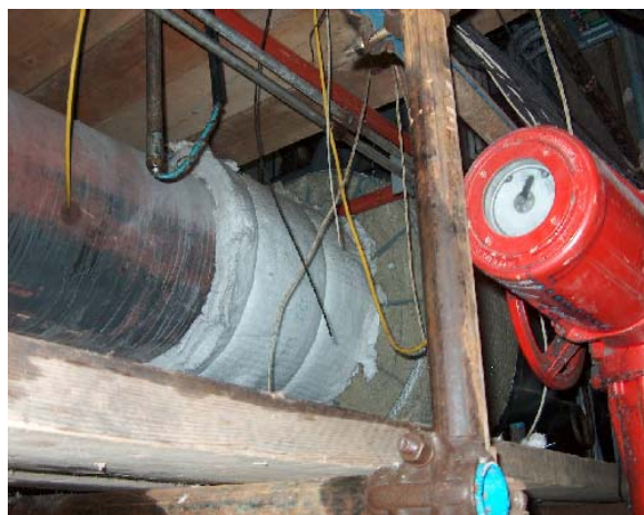
Foto 12. Vari strati di coibente sulla tubazione
